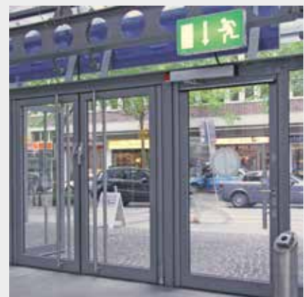
Die Rettungswegbeschilderung über dem Ausgang ist gut sichtbar und beleuchtet
