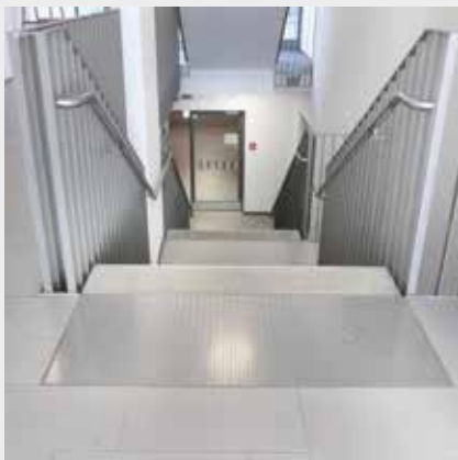
Das Aufmerksamkeitsfeld aus Tränenblech ist gut tastbar und erfüllt auch die Anforderungen an die Rutsicherheit
