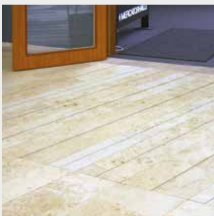
In die Bodenplatten eingefräste Rillen bilden ein taktiler, jedoch nicht kontrastreiches Aufmerksamkeitsfeld vor einem Saaleingang
