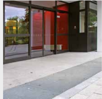
Ein feinmaschiges Drainage-Gitter vor dem Eingang ist auch für Personen im Rollstuhl oder mit Gehbehinderung geeignet
