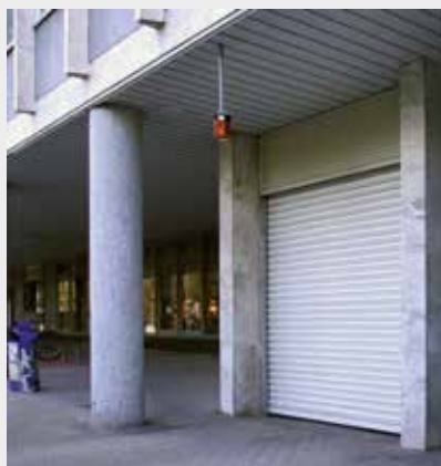
Die Blitzleuchte an einer Tiefgaragenausfahrt warnt Vorbeigehende optisch und akustisch vor querenden Autos
