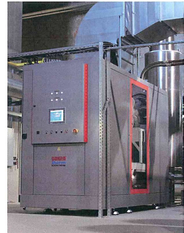
Erdgas-BHKW mit 500 kW Leistung
