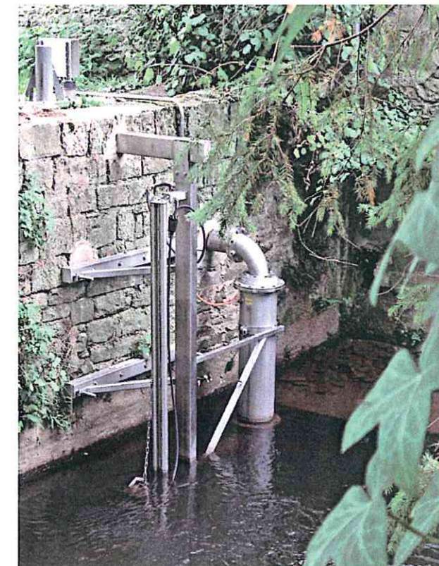
Entnahmestelle aus dem Mühlgraben der Lauter
