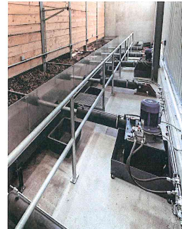
Holzheizwerk am Berliner Platz
